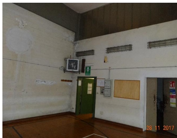
Figura 4.7 - Particolare installazione aerotermini
