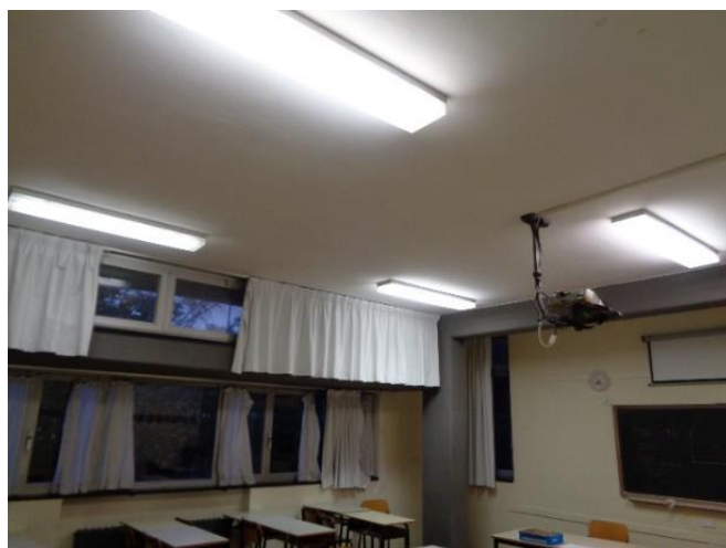
Figura 4.18 - Particolare dei corpi illuminanti ubicati nelle aule
