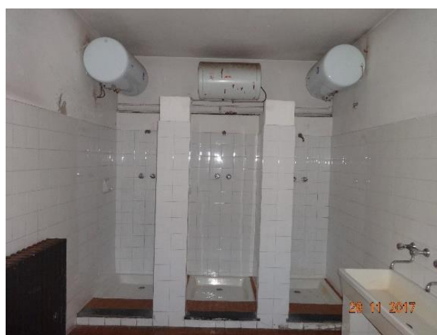
Figura 4.16 - Boiler elettrici spogliatoi palestra
