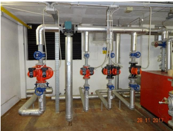
Figura 4.8 - Particolare della pompa di circolazione
